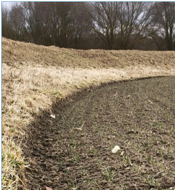
Abb. 4: Auf dem Foto geht der Deich mit Abbruchkante in den Acker über. Das soll in Zukunft mit Schutzstreifen auch an älteren Deichen nicht mehr sein.
