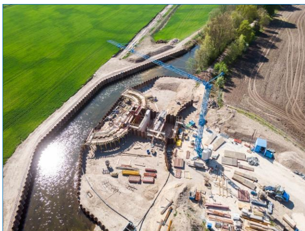
Abb. 4: „Das Foto zeigt den Bau des Drosselbauwerks in Thann- hausen (Quelle: Wasserwirt- schaftsamt Donauwörth“.
