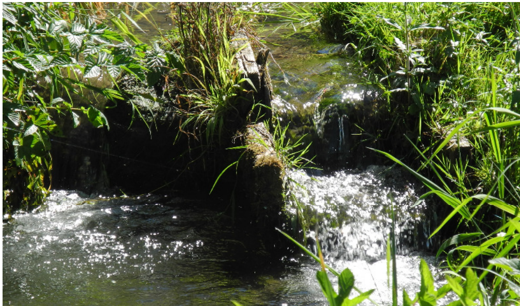
Abbildung 2: nicht durchgängiger Absturz in der Wanderhilfe am Triebwerk Stork.
