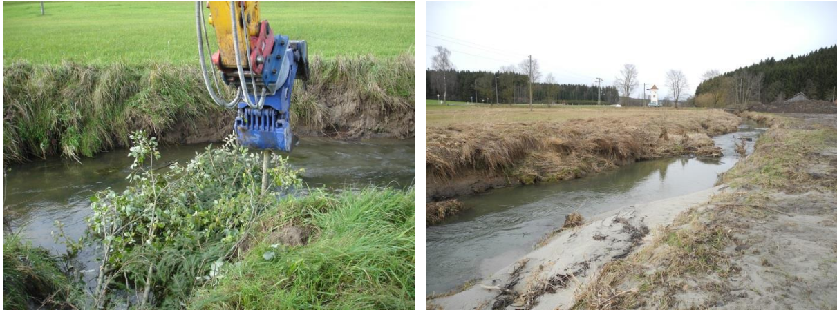
Abb. 6: Beispiel für den Einbau eines Leitwerkes aus Totholz (Astmaterial, Fichte) und Sandanlandung an derselben Stelle nach 3-4 Jahren. Die Sohle ist in diesem Bereich von der Sandauflage befreit und kiesig überspült.
